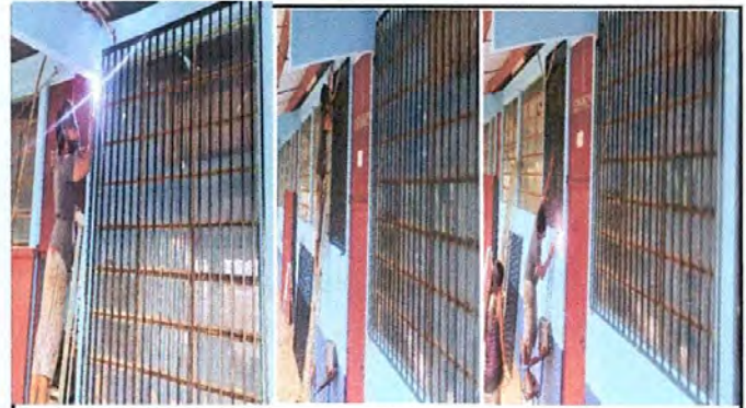
Foto 4: Sutipución de balcones de metal
