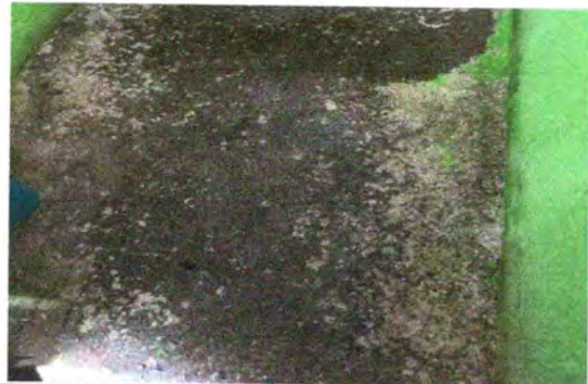
Foto 4: Piso de cemento en mal estado
