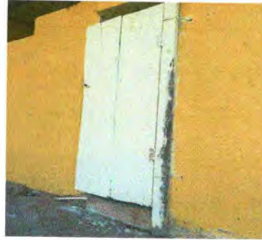
Foto 2: Puertas de baño en mal estado
