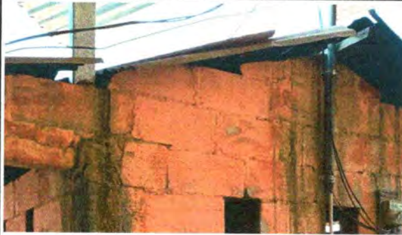
Foto1: Pared en mal estado
