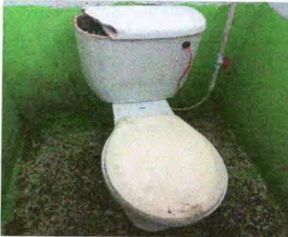
Foto 3: Baño en mal estado
