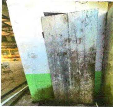
Foto1: Puerta de baño deteriorada
