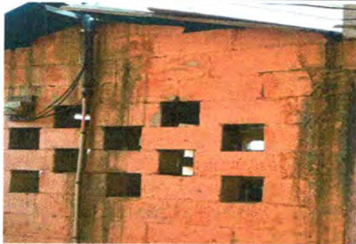
Foto 3: Baño en mal estado
