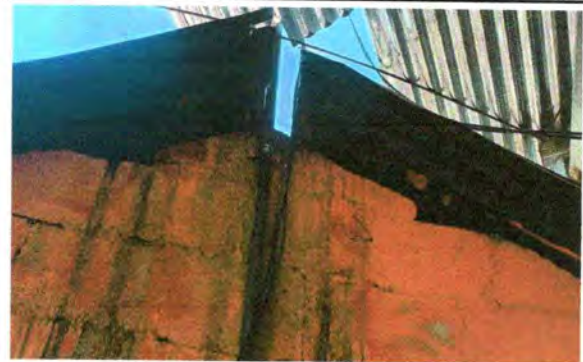
Foto 4: techo de lámina en mal estado
