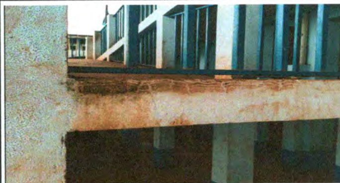
Foto 4: Es evidente el mal estado de la pintura tanto en los muros como en las columnas.
