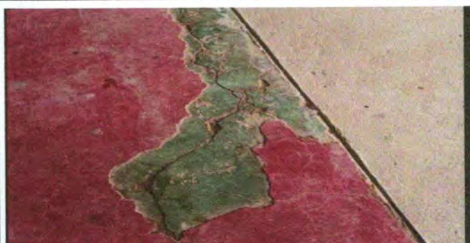
Foto 2: El mal estado del piso no sólo es antiestético, sino que representa un peligro para los estudiantes que pueden tropezar en las grietas.
