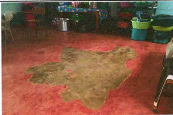
Foto 1: El piso se encuentra en mal estado por lo que es necesario sustituirlo por mosaico de granito.
