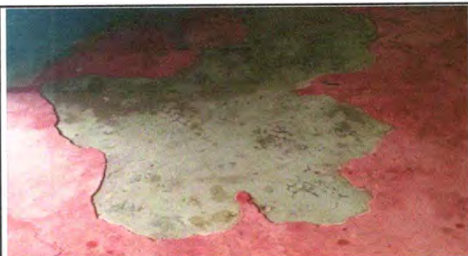
Foto 3: Debido al mal estado del piso se han suscitado algunos accidentes cuando los estudiantes transitan por las áreas afectadas.
