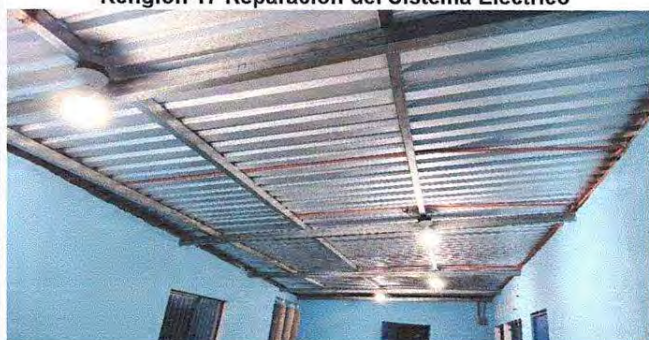
Foto 20. Bombillas y apagadores funcionando al 100%
