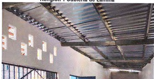
Foto 4: Así quedó la cubierta de lámina
