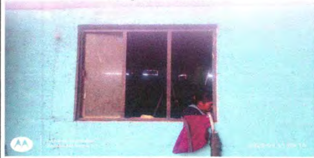
Foto 9: Ventanas de la cocina demasiado pequeña, necesita ampliación
