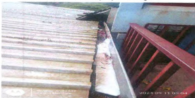
Foto 13: Los canales de metal estan en malas condiciones
