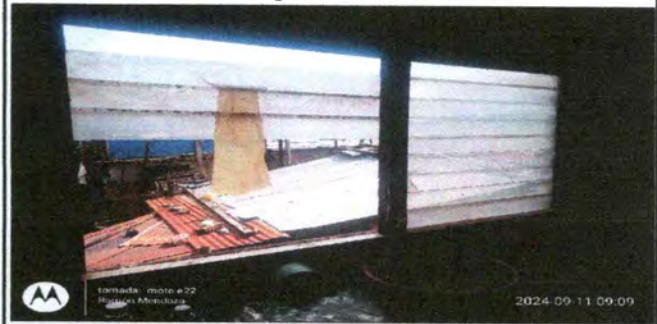
Foto 10: Ventana en malas condiciones, se cambiará por ventana de metal o valcon para una mejor ventilación
