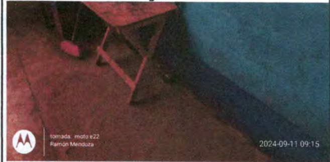
Foto 12: se debe mejorar el piso de concreto
