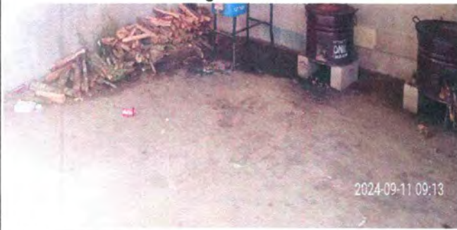
Foto 11: El piso de concreto no es muy aceptable en las condiciones que se encuentra
