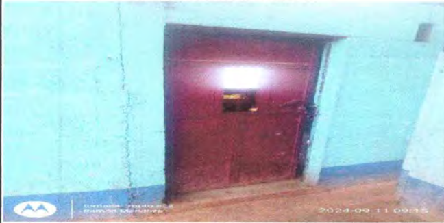
Foto 7: La Puerta de acceso a la cocina es muy angosta
