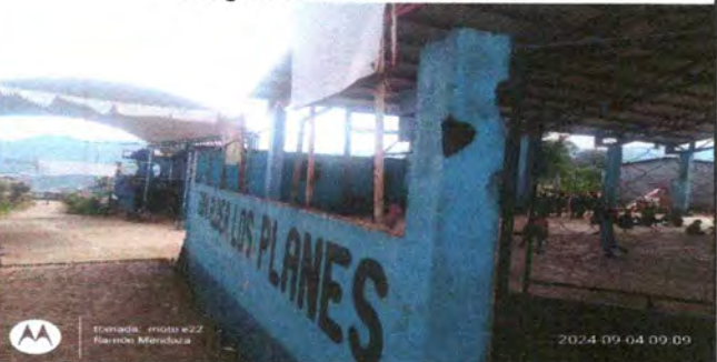
Foto 17: Los Muros perimetrales se encuentran incompletos.
