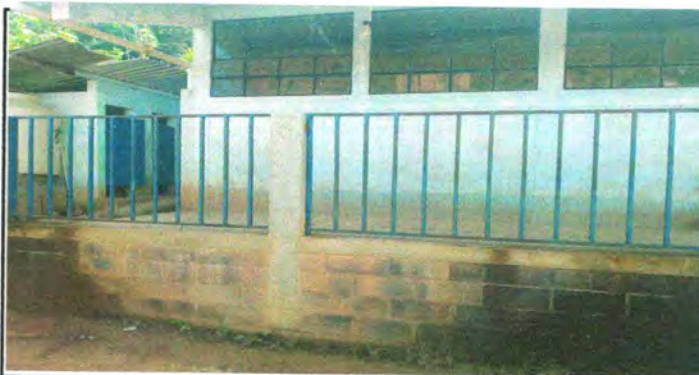
Foto 6: Barandales que se encuentran en mal estado
