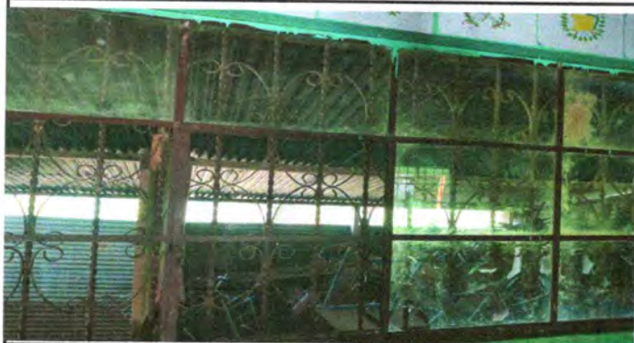
Foto 1: estado en que se encuentran los vidrios y ventanas del Establecimiento.
