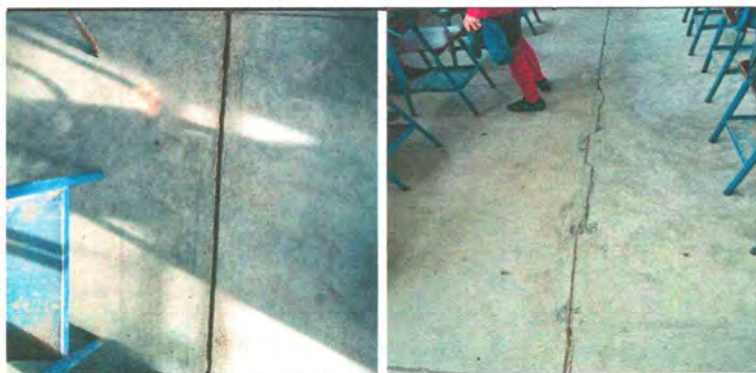
Foto 5: Se evidencia las grietas en el piso
