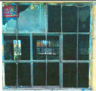
Foto 8: Vidrios de ventanales quebrados
