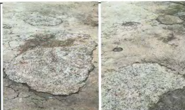
Foto 10: Piso del módulo de aula en malas condiciones
