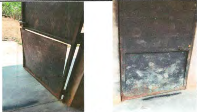
Foto 5: Puerta de aula en mal estado
