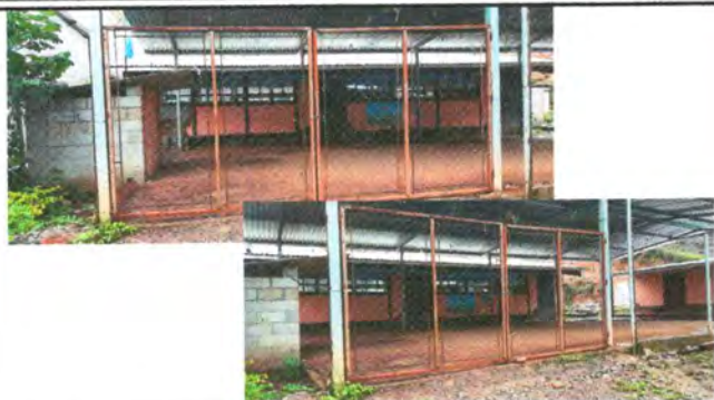
Foto 7: Portón de malla deteriorado
