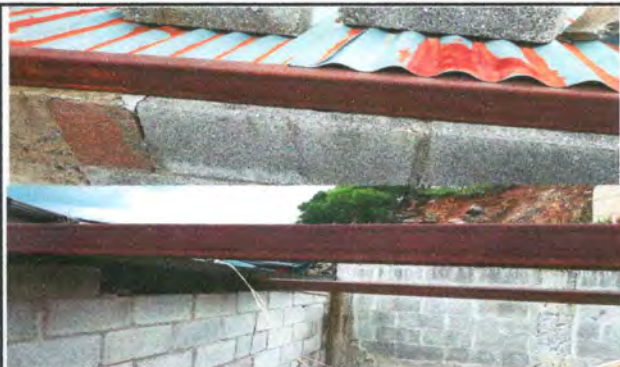
Foto 4: Costaneras de metal en estado óxido
