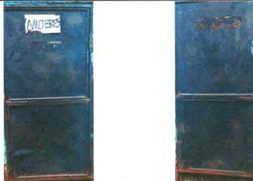
Foto 6: puertas de los sanitarios en mal estado
