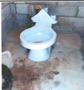
Foto 11: Sanitarios en malas condiciones
