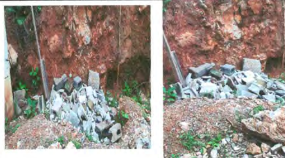
Foto 12: Muro de contención se desplomó
