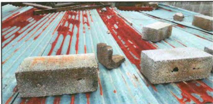
Foto 3: Módulo de aula está improvisado el techo no tiene sujetadores
