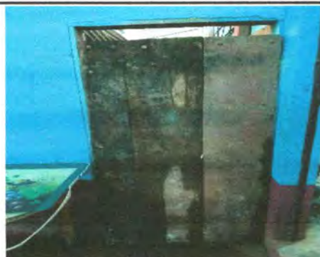
Foto 4: PUERTAS DE METAL
