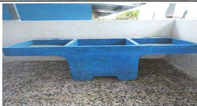
Foto 19: pila de cemento de 2 lavamanos
