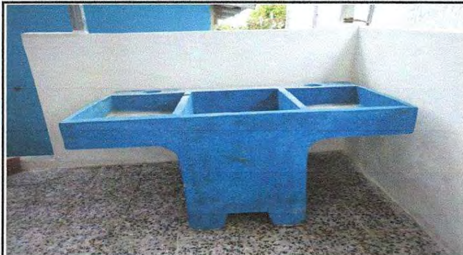
Foto 20: pila de cemento de 2 lavamanos
