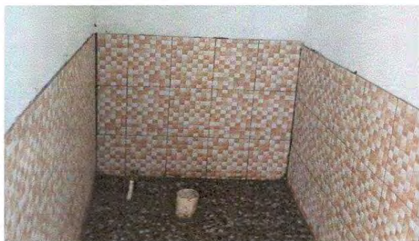
Foto 15: Sustrucción de inodoro
