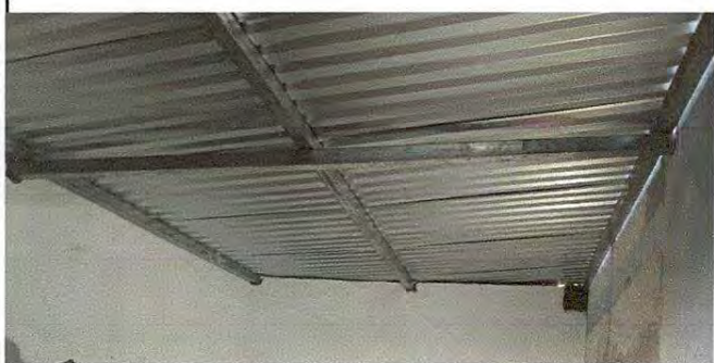
Foto 3: Cubierta de lámina en mal estado
