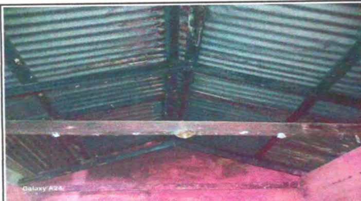
Foto 3: Cubierta de lámina en mal estado
