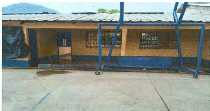
Foto 1: lámina en malas condiciones
