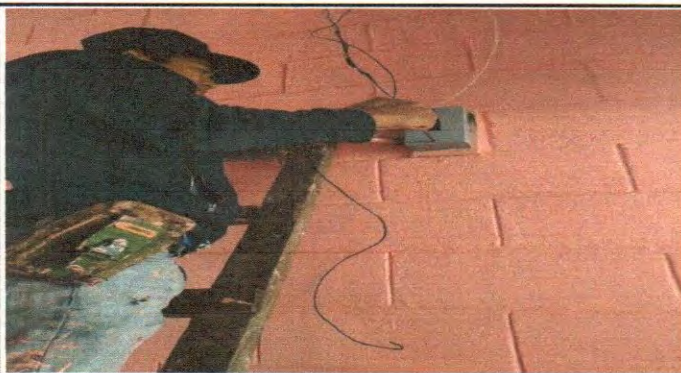
Foto 3: Instalación de flipon de 1 circuito
