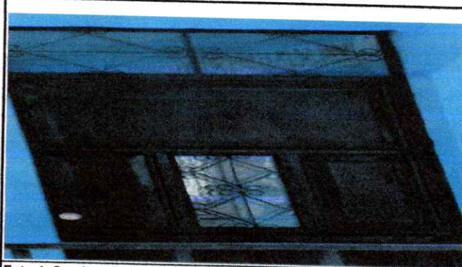
Foto 4: Sustrucción de Chapa
