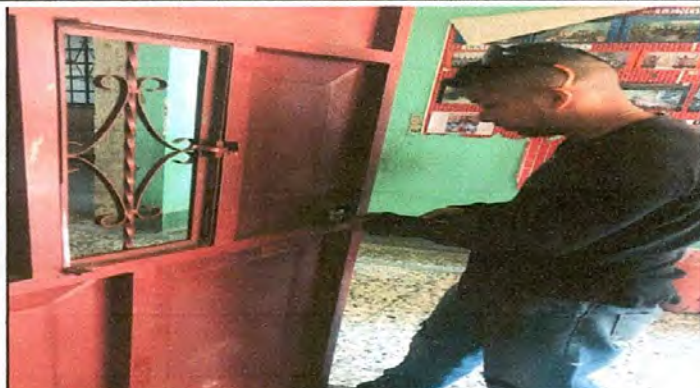
Foto 2: Puertas de metal en mal estado
