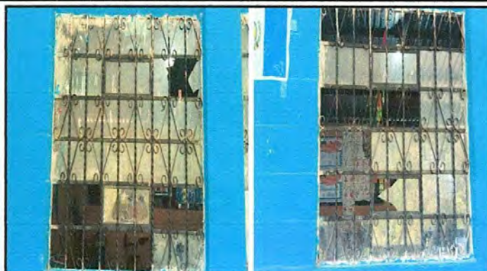
Foto No. 2 Los vidrios de las ventanas estan quebradas y manchadas
