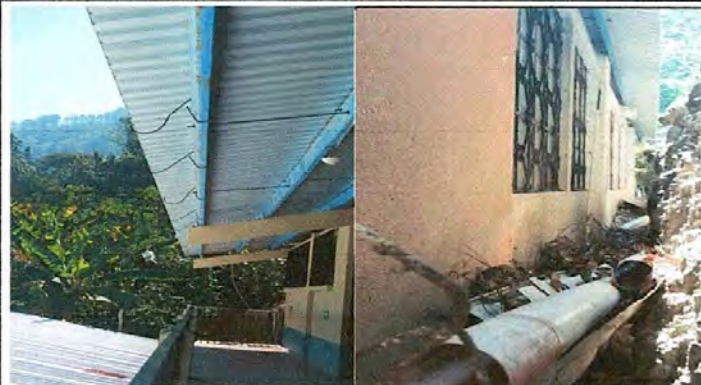
Foto No. 1 Los canales de pvc estan quebradas en su totalidad.
