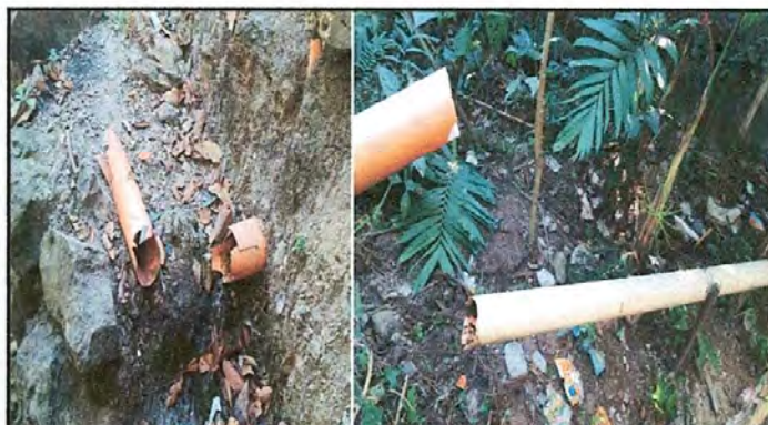
Foto No. 4 La tubería de drenaje estan quebradas.
