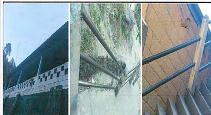
Foto No. 3 El corredor no cuenta con barrandas es peligroso se pueden caer niños y así mismo las barrandas de tubos en las gradas es resbaloso.
