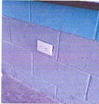
Foto 7. Interruptores, toma corrientes en mal estados
