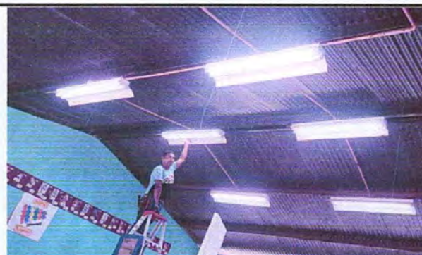
Foto 6. Sustitución de sistema eléctrico, por lamparas LED
