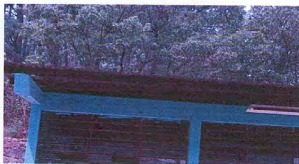
Foto 3. Estaban los canales, pero ya se deterioraron y se cayeron
