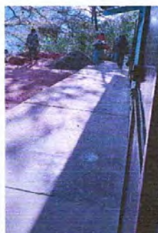
Foto 9. Reoaración de piso de torta de concreto, esta en mal estado
