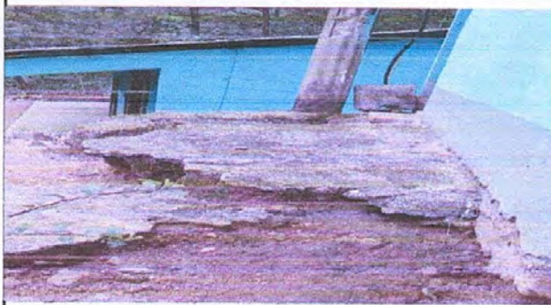
Foto 9. Reoaración de piso de torta de concreto, esta en mal estado
