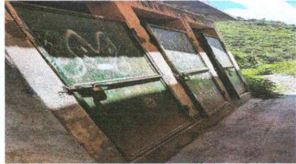
FOTO 2 debido al deterioro de la losa penetra el agua y se corre el peligro de un asentamiento o deslizamiento
