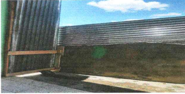
FOTO 1 Mejoramiento de baranda de metal ya que es un peligro para los niños
