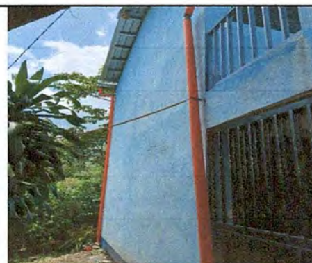
Foto 10: Canales y tubos para bajadas de agua atrás de las aulas del Módulo 2.
