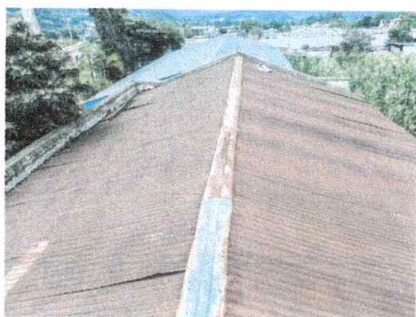
Foto 1: lámina en malas condiciones
