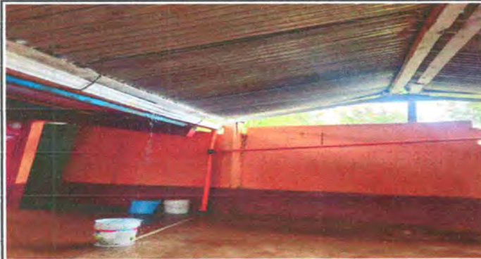
Foto 1: Los canales son pequeños y no soportan el caudal de agua.
