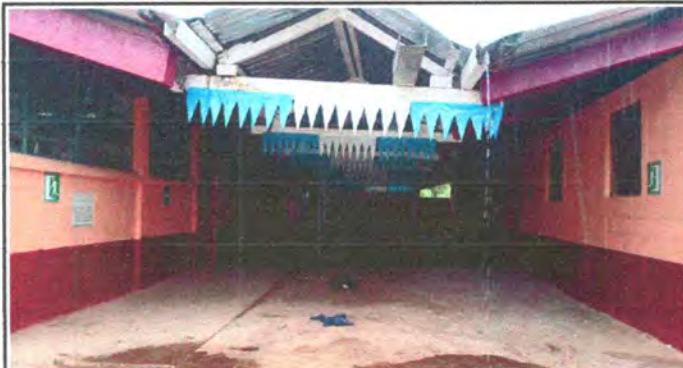
Foto 3: El techado esta muy bajo y las laminas estan deterioradas por lo mismo es necesario la remodelación.
