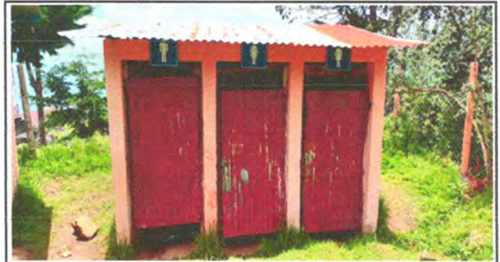
Foto 4: Las puertas de los servicios sanitarios estan en mal estado.
