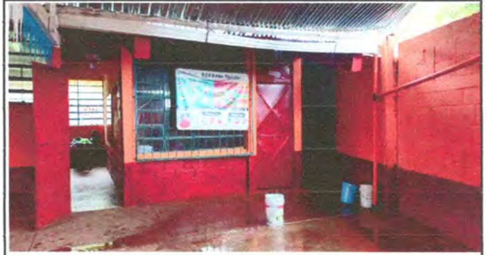
Foto 2: Los tubos no son resistentes por lo mismo toda el agua cae en el corredor.
