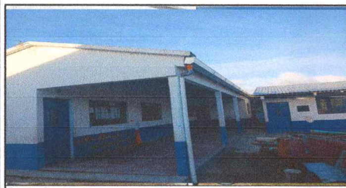
Foto 5: Cambio de canal
