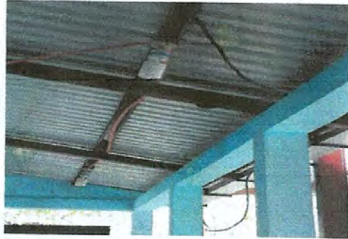
Foto 7: Sustrucción de cableado eléctrico
