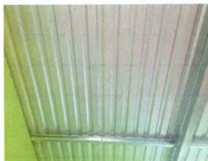
FOTO 4: levantamiento y colocación de lamina, debido a la mala posición
