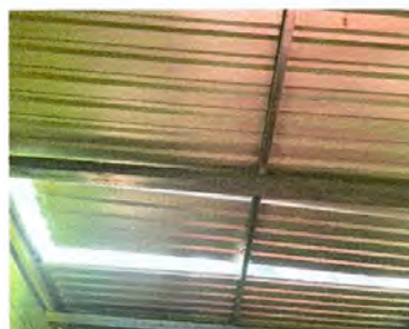
FOTO 4: levantamiento y colocación de lamina, debido a la mala posición
