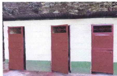
Foto 6: De puertas en servicios sanitarios
