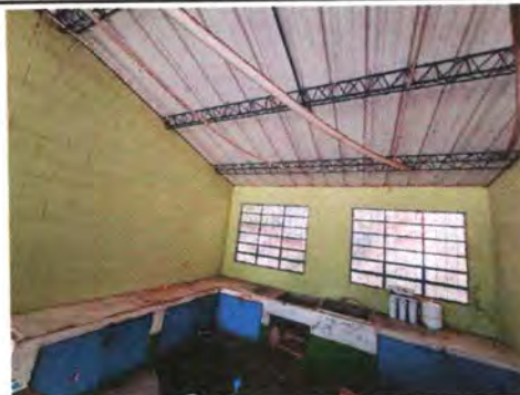
Foto 2: Sustrucción de azulejo en muebles de cocina
