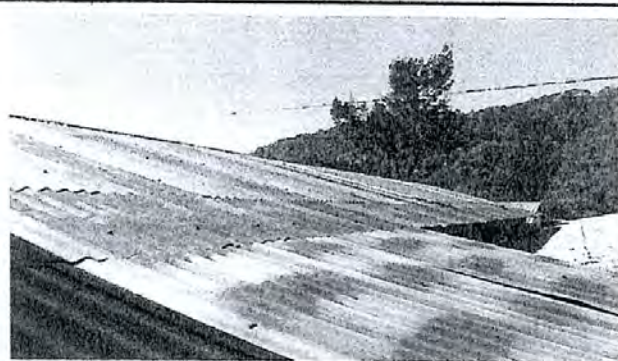
Foto 2: Techado en mal estado
