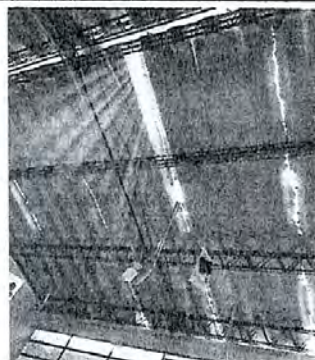
Foto 4: Techo de las aulas en mal estado
