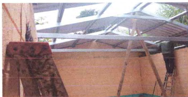
Foto 1: Sustrucción de estructura de techo del aula 2
