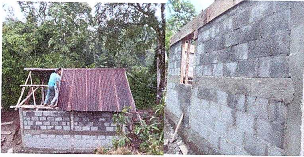
FOTO 1 CUBIERTA DE LÁMINA. Sustrucción de láminas por láminas troqueladas
