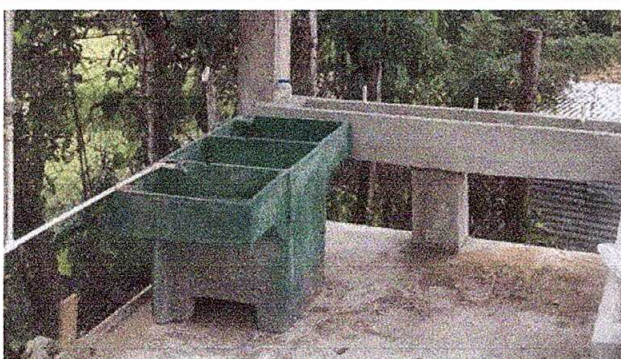
Foto 3: PILA Y LAVAMNOS EN MAL ESTADO
