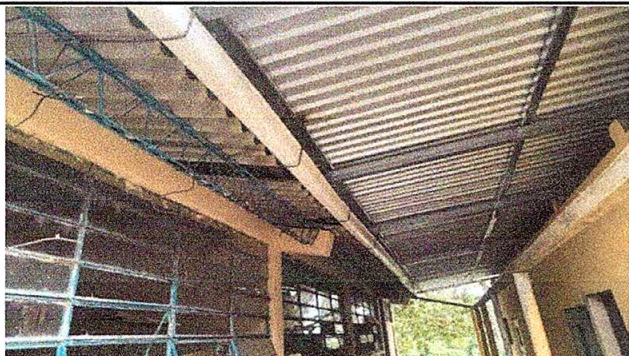
Foto 5: CANALES DE AGUA NO ADECUADO PARA LA LLUVIA
