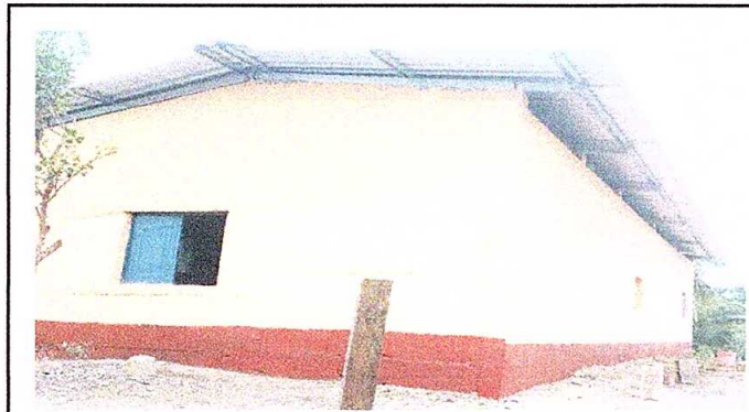
Foto1: TECHO DE AULA EN MAL ESTADO
