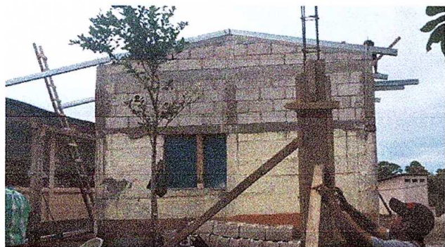
Foto1: TECHO DE AULA EN MAL ESTADO
