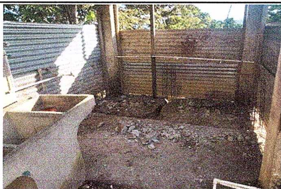
Foto 3: PILA Y LAVAMANOS EN MAL ESTADO.
