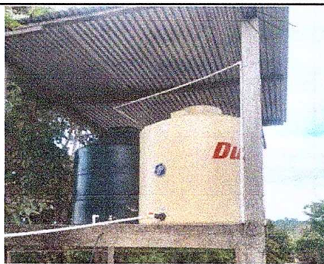
Foto 4: DEPOSITO DE AGUA EN MAL ESTADO.
