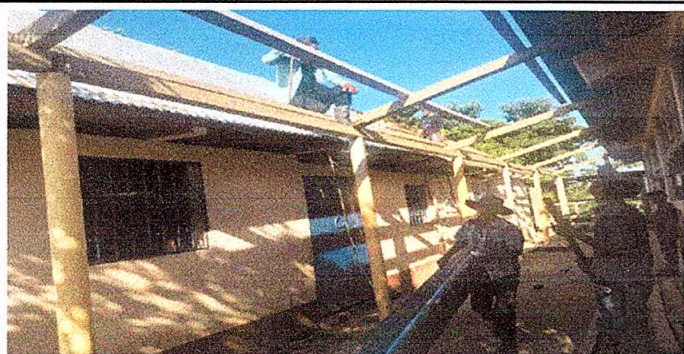
Foto 5: CANALES DE AGUA NO ADECUADO PARA LA LLUVIA
