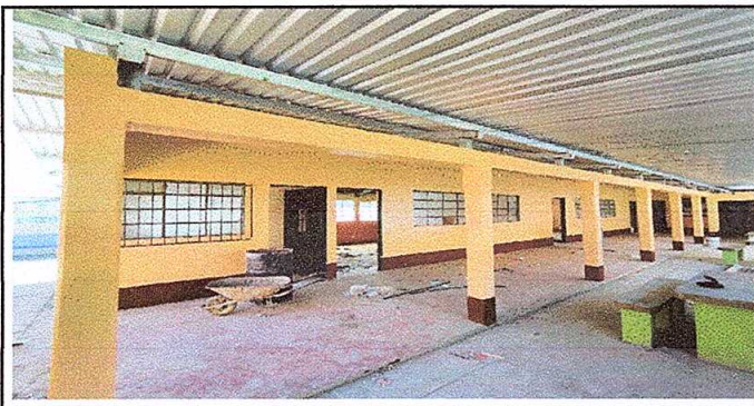
Foto 5: Pintura de la escuela en malas condiciones
