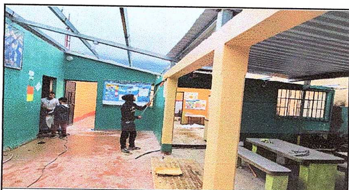
Foto 5: Pintura de la escuela en malas condiciones
