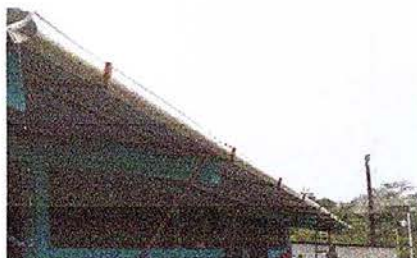
Foto 12: Soporte de canaleta
