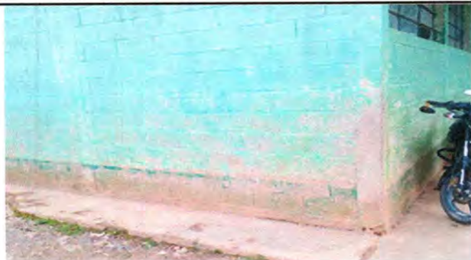
Foto 7: pintura en pared exterior
