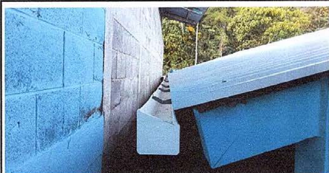
FOTO No. 5 Sustrucción de Canal
