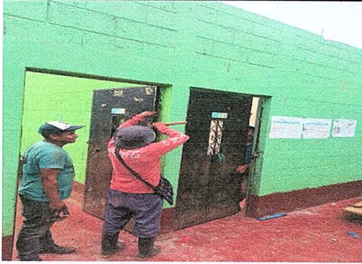
Foto1: sustitucion de puertas en mal estado
