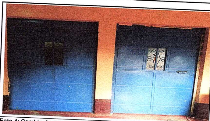
Foto 4: Cambio de puertas de 2 aulas con las medidas de 1 metro de ancho por 2.15 metros de alto, que se encuentran en pesimas condiciones.
