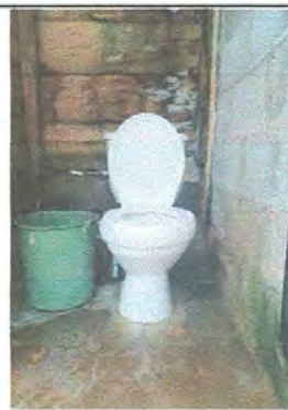
Foto 2 el nuevo sanitario
