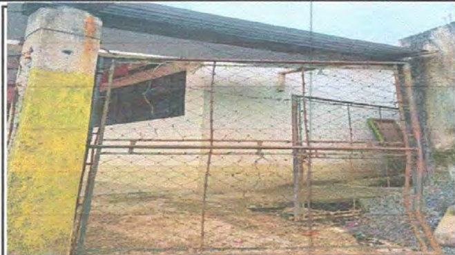
Foto 1: Portón en malas condiciones
