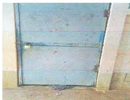
foto 4: Puertas en malas condiciones
