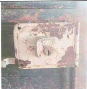
Foto9: Sustrucción de chapas en puerta de metal
