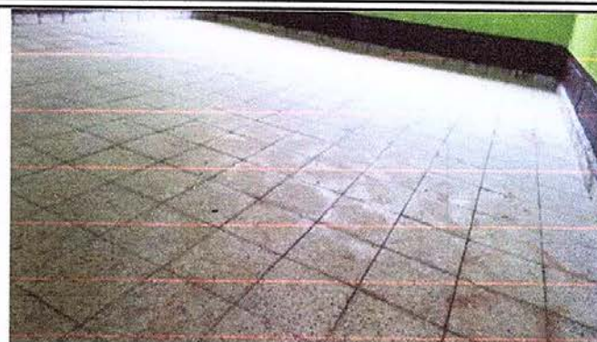
Foto 2: Aula No. 02. La segunda aula se encuentra en las mismas condiciones con un piso deteriorado.
