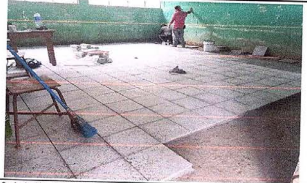
Foto 2: Aula No. 02. La segunda aula se encuentra en las mismas condiciones con un piso deteriorado.
