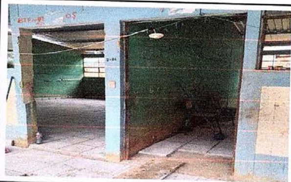
Foto 4: Cambio de puertas de 7 aulas mismas que se encuentran en pesimas condiciones las cuales ya no ofrecen seguridad al inmoviliario que posee el Centro Educativo.
