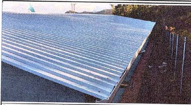
Foto 1: CUBIERTA DE LÁMINA. Láminas en malas condiciones
