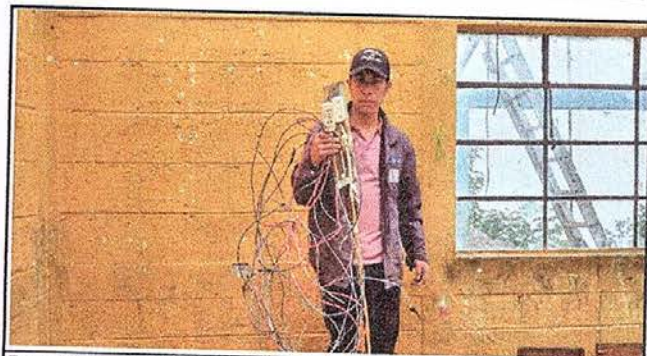
Foto 12: Sustrucción de toma corrientes
