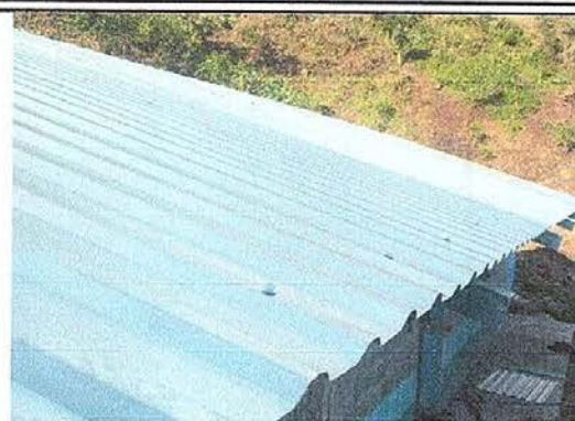
Foto No. 2: Sustrucción de lámina en malas condiciones
